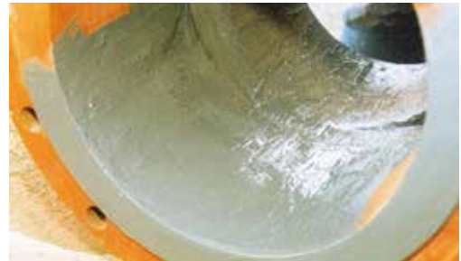
Trauriger Reparaturalltag – aufgespritzte Epoxykeramik. Kein Techniker möchte solch strömungsproblematische Oberflächen noch sehen. „Gut“ geht heute anders ...
