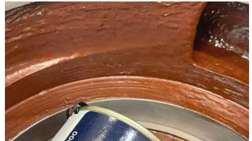
Trauriger Reparaturalltag – aufgepinselte Epoxykeramik. Kein Techniker möchte solch turbulenzbildende Irrtümer noch sehen. „Gut“ geht heute ganz anders ...
